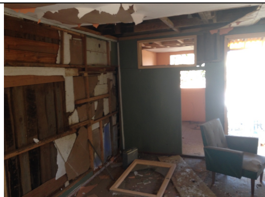
Foto N° 5: Vista al interior de la casa de la propiedad de autos. Nótese el saqueo y abandono de la propiedad
