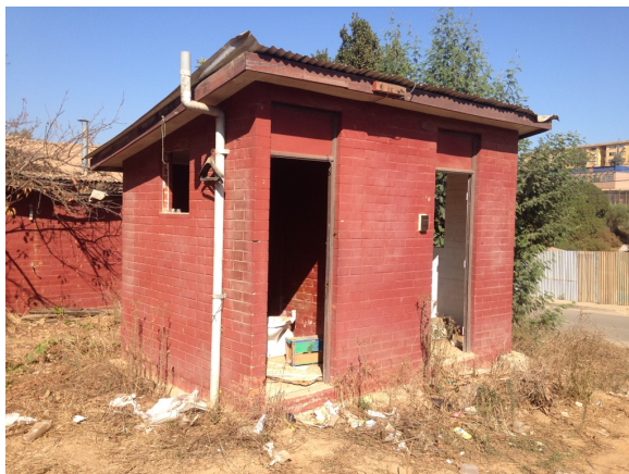
Foto N°12. Vista de caseta sanitaria de propiedad contigua a la propiedad de autos. Nótese el saqueo de sus artefactos y el acceso libre a la calle. Atrás de la caseta, la propiedad de autos.
